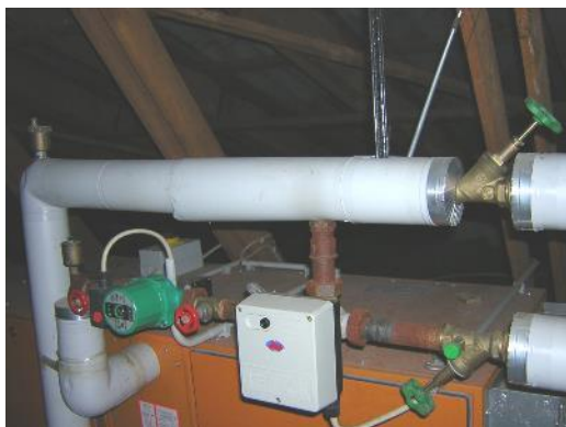
Bild 05: Lüftungsanlage auf dem Dachboden
