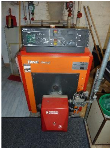
Heizkessel mit Gebläsebrenner
