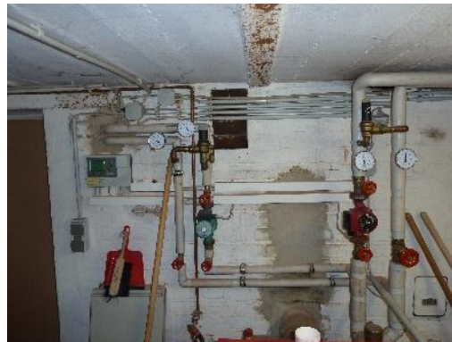
Heizwärmeverteilung im Heizungsraum
