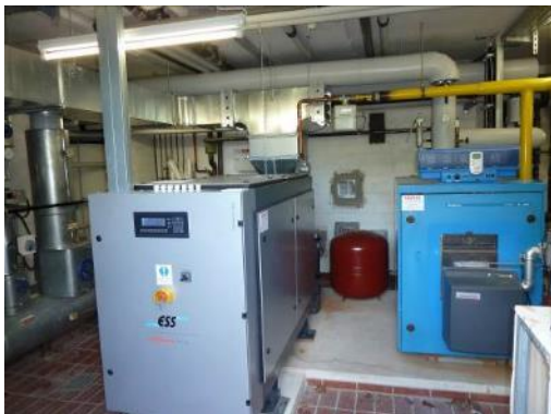
Blockheizkraftwerk mit Kessel
